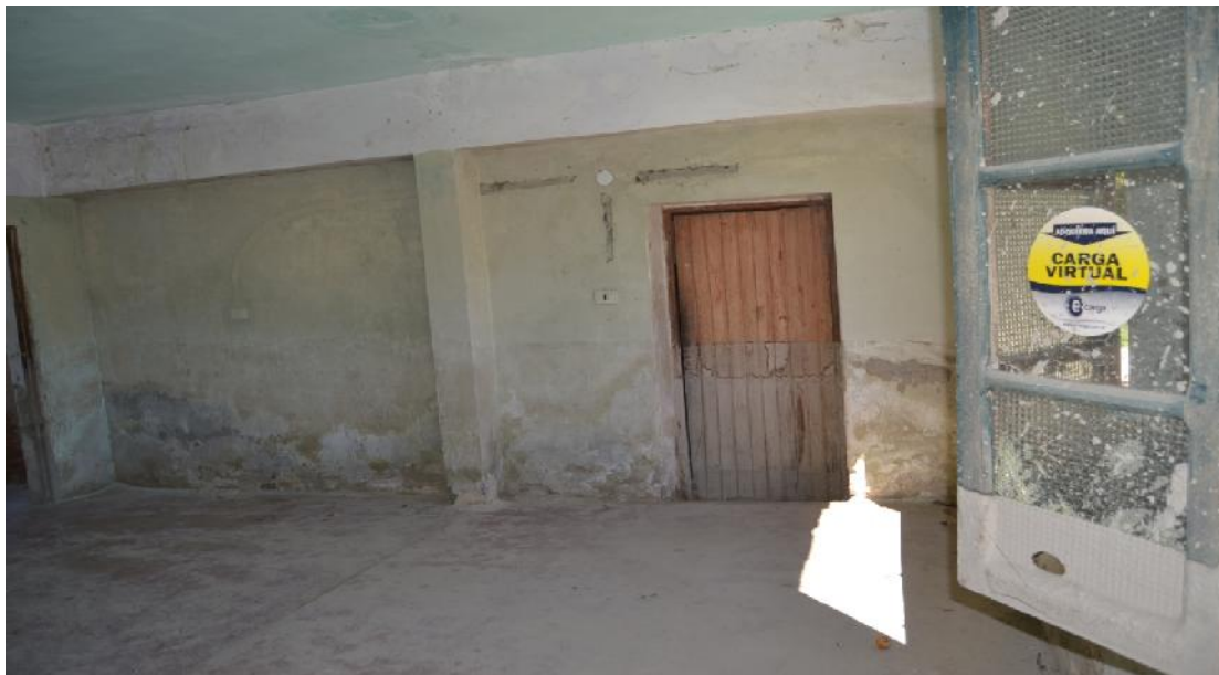
Imagen N°4: En la fotografía se puede observar cómo quedó una vivienda ubicada en la calle principal de la localidad.
