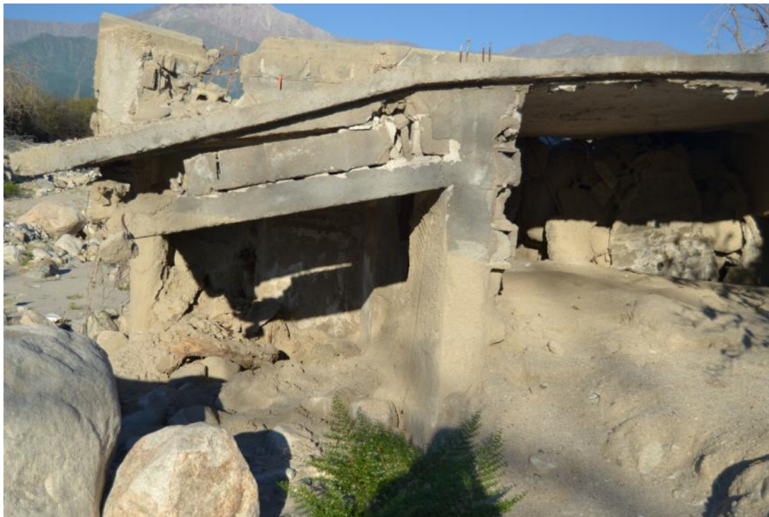
Imagen N°6: En esta fotografía se puede observar el estado de la vivienda tras el paso del alud, la misma se encontraba sobre la margen derecha del río.
