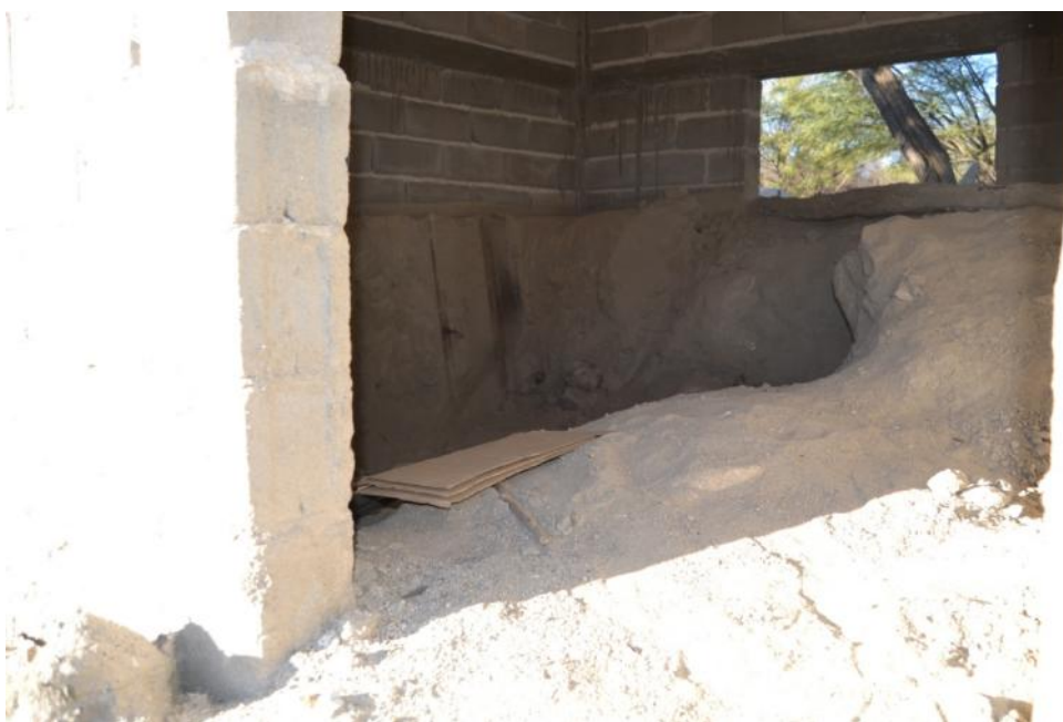
Imagen N°5: En esta fotografía se puede observar el material sólido que se depositó en una vivienda localizada en el río Siján.
